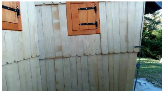
Slika 118: Lepo viden rob spodnjega dela fasade, ki je narejena v konus proti tlem. Ob robu je napeljan strelovod, Naratova bajta na Šimnovcu.
