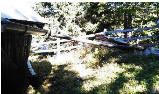
Slika 125: Žleb je s strehe speljan v čistilno napravo in vodnjak, Jakšetova bajta na Šimnovcu.
