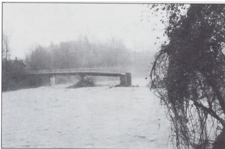
Slika 12. Homec—Radomlje: delno porušen most.
