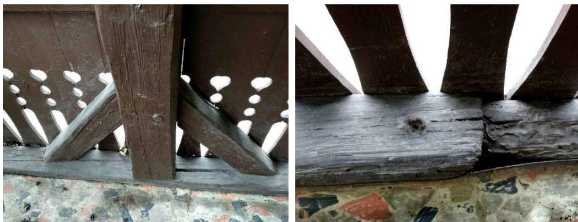
Sliki 99 in 100: Zaključni tram, opore in steber predstavljajo ogrodje ganka, ki ga leta 1978 niso menjali. Desno: stik dveh originalnih tramov, desni je v nekoliko slabšem stanju.
