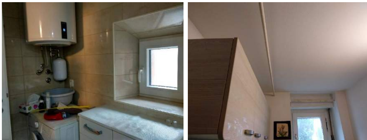
Sliki 79 in 80: V kopalnici je zid debel 73 cm (pri oknu vidimo le notranji del). Desno: V kuhinji je pod stropom notranji del železne horizontalne vezi, ki skrbi za večjo stabilnost in protipotresno varnost hiše.
